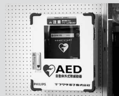
役場ホールに設置されているAED
