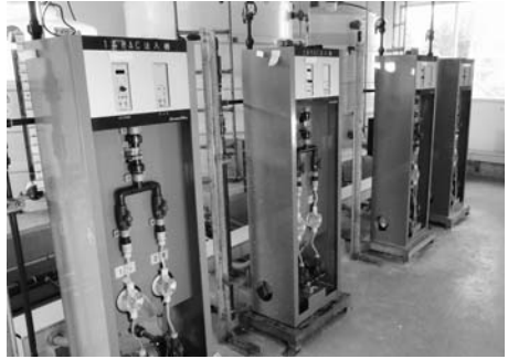
平泉浄水場薬品注入機
