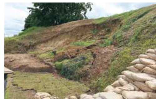
写真1 調査当初(北から) 大きく崩れ落ち中腹から裾側に土砂が広がり、水路まで塞いでいました。崩れていない箇所も亀裂が広がっていました。
